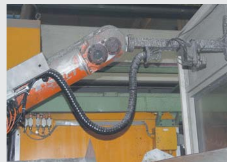
Triflex® R 应用于镁合金压铸业（高温，污垢，油污，金属碎屑，灰尘等） - 保障安全运行
